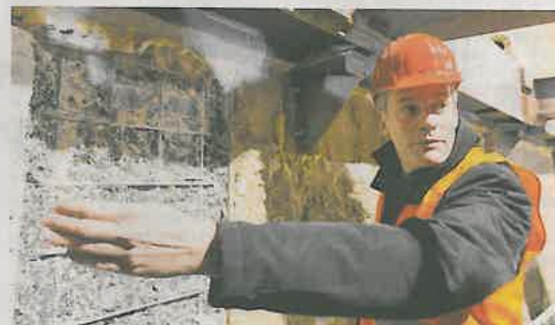
Der Geschäftsführer für die technische Federführung des U-Bahn-Baus, Jochen Keysberg, zeigt die Stelle, an der stabilisierende Stahlbügel fehlen. FOTO: DPA
