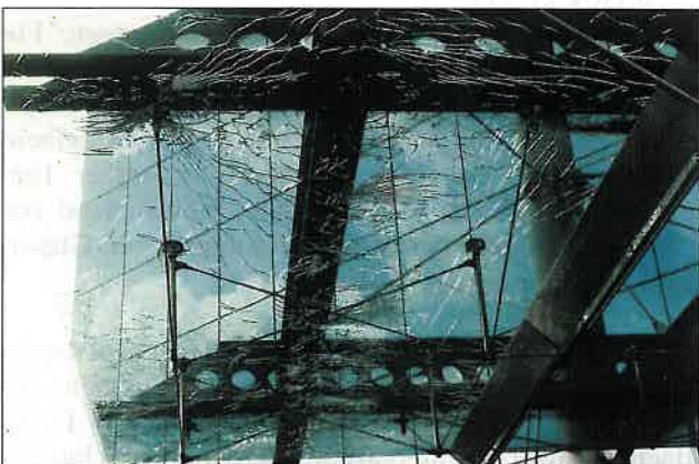
Abb. 6: Schadensbild des Vordachs bei Ausführung in VSG aus TVG, verursacht durch erneutes Anstoßen eines LKW
