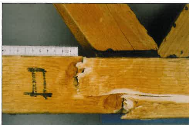
Abb. 2.1 und Abb. 2.2: Zugbruch des Gurts eines Fachwerkträgers
